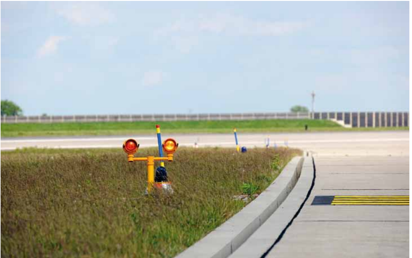
Runway Guard Lights - an vielen Flughäfen ein Mangelkriterium
